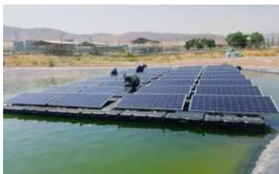
شکل ۷. نیروگاه خورشیدی شناور شرکت پتروشیمی مهاباد
