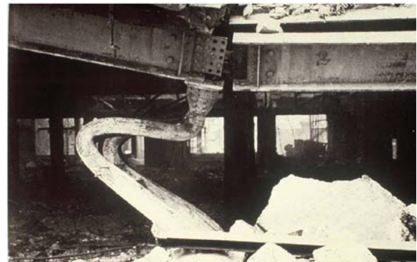
شکل ۱- گسیختگی اتصال ناشی از انفجار در سازه
