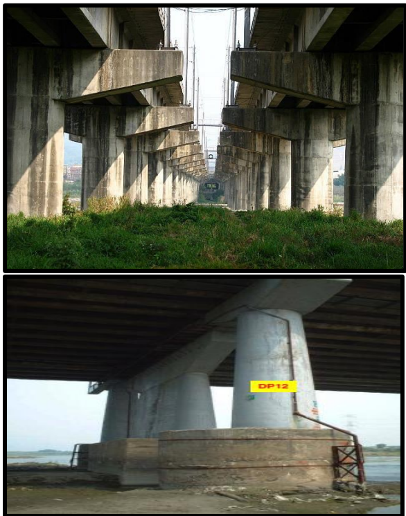
شکل (۹): استفاده از حسگرهای FBG در پایه‌های پل دادو در تایوان [۳۰]
