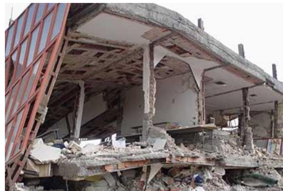
شکل (۱۲): نمونه از طبق نرم در زلزله کرمانشاه
