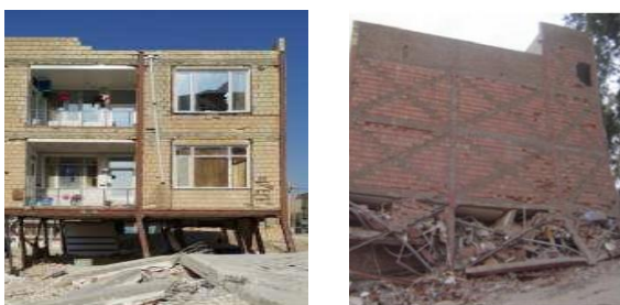
شکل (۱۶): نمونه از طبق نرم در زلزله کرمانشاه
