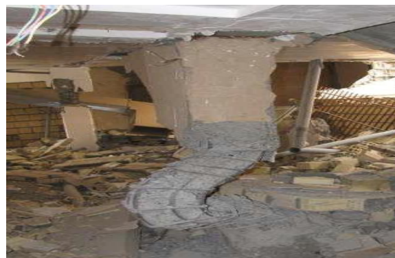
شکل (۲۰): کیفیت نامطلوب بتن، فاصله زیاد خاموت‌ها
