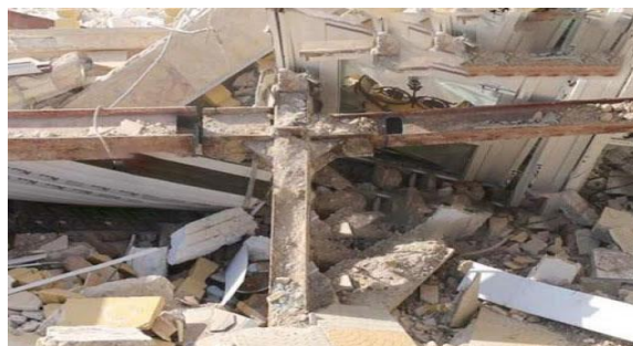
شکل (۱۷): عدم رعایت ستون قوی و تیر ضعیف در زلزله کرمانشاه
