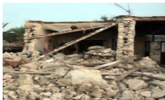
شکل (۲۱): نمونه‌ای از خرابی سقف طاق ضربی در زلزله بم
